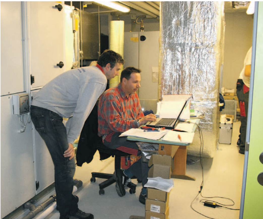
Blick in die technische Machtzentrale, wo in dieser Woche noch die Feinabstimmung durchgeführt wurde.
