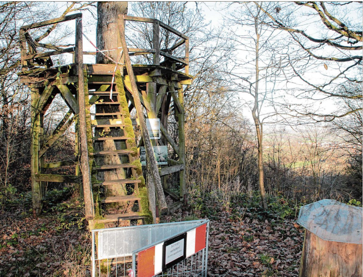
Der Aufstieg zum „Teufelhäuschen“ ist bereits gesperrt.
