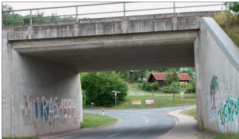
Eine professionelle Bemalung soll dem Graffiti-Problem an der Bahnbrücke über die Äußere Bahnhofstraße ein Ende setzen. Foto: Christine Berger
