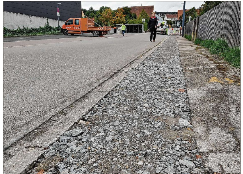
Der Schotter muss wieder verschwinden. Der Gehweg an der Schule bekommt eine neue Oberfläche. Foto: Katrin Merklein
