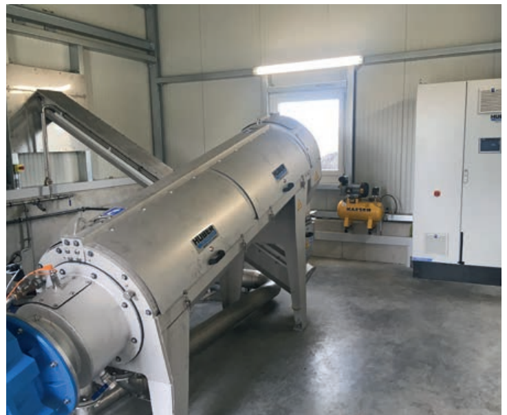
Im Inneren der Halle: Die Presse, sowie der Schaltschrank
