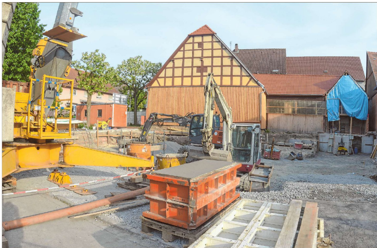
Die Arbeiten stehen noch am Anfang, die Kosten für das Ärztelhaus steigen schon jetzt.
