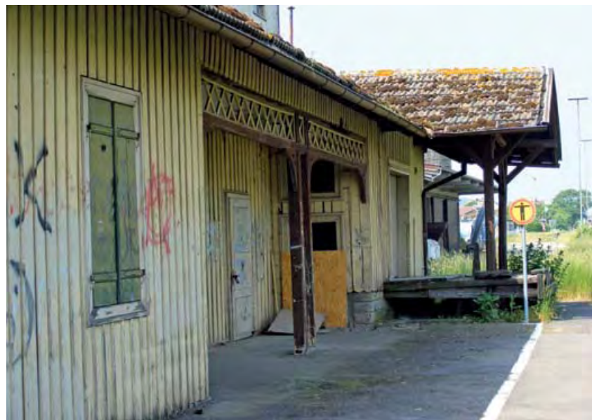
Handlungsbedarf erkannt: Am Burgbernheimer Bahnhofsgebäude nagt schon länger der Zahn der Zeit. Fotos: Berger
