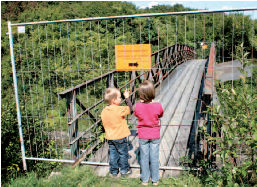
Wegen Einsturzgefahr wurde die Fußgängerbrücke nahe dem Skilift noch gestern gesperrt. Foto: Berger
