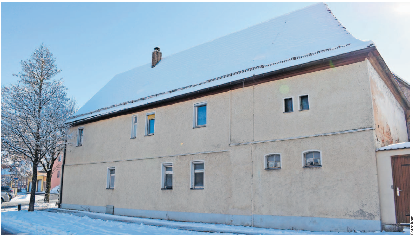
Das Haus an der Ecke Marktplatz und Rodgasse wird abgerissen. Arztpraxis und medizinische Fitness sollen im Neubau Platz finden.
