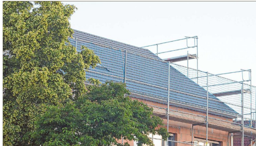
Das Dach des Anstoßes in Burgbernheim.
