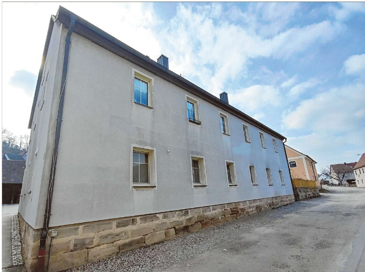
Die Rodgasse soll bald wieder hergestellt sein – anschließend könnte es mit der energetischen Sanierung des Wohnhauses weitergehen. Foto: Katrin Merklein
