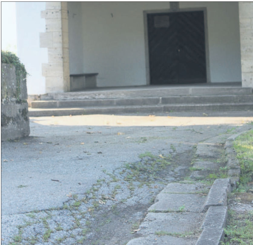
In sehr schlechtem Zustand ist der Weg zur Leichenhalle. An den Kosten der bevorstehenden Sanierung wird sich die Stadt nicht beteiligen. Foto: Christine Berger
